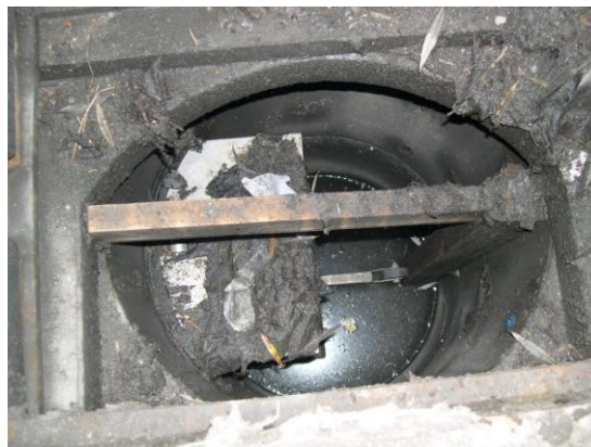
Bild 5.5 SorbClean monterad i brunn och efter några månaders drift.
